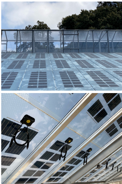
Figura 3: Dimostratore agrivoltaico in pieno campo, con impiego di vetri fotovoltaici progettati da ENEA per una piena funzionalità rispetto alla trasmissione luminosa all'interno della serra ed all'integrazione con il contesto di pregio. Presso l'Orto Botanico realizzato presso il giardino della Reggia Borbonica di Portici, sede del Museo delle Scienze Agrarie (MUSA) e della Facoltà di Agraria dell'Università degli Studi di Napoli Federico II. Vetri fotovoltaici realizzati da SunAge.
